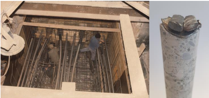
Abb. 2: Verlegung der Längsvorspannung und Bohrkern mit Spannstahl Sigma Oval der Quervorspannung des Altstadtringtunnels, Foto Bauzeit: Landeshauptstadt München, Bohrkern: Feix Ingenieure
